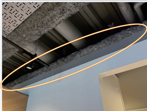
施設内の結露発生場所
